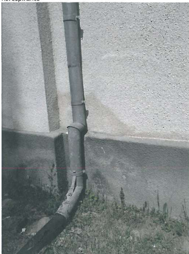
1.8. Racord navă-cor, fațada bisericii - umiditate excesivă datorită sistemului deficitar de colectare a apelor pluviale
