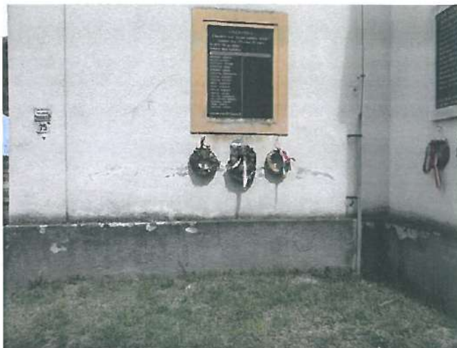
1.5. Turnul bisericii, fațada sud - umiditate ridicată pe tot conturul turnului datorită capilarității și finisajelor nerespirante
