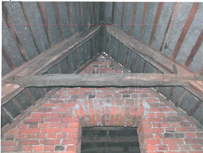
4.14. Moază biologic degradată - rezistență redusă
