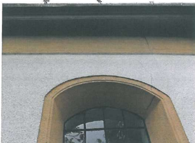
1.18. Cor biserică, fațada est - fisură structurală pornind de la colțul ferestrei și traversând zidăria până la streășină
