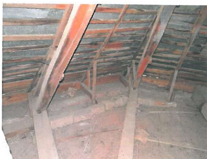
4.11. Îmbinări tip cepuire, înclinate, dislocate între căpriori și semicorzi în zona închiderii șarpantei, moduri de lucru deficitare
