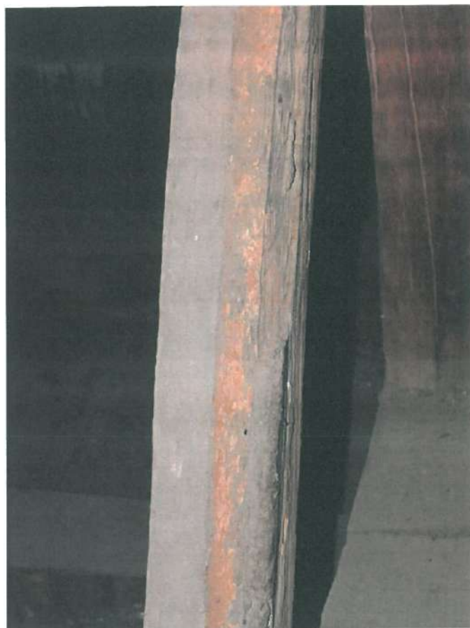
4.16. Material lemnos degradat biologic - relevul degradărilor biologice este detaliat în expertiza de biologia construcțiilor, elaborată pentru șarpanta bisericii
