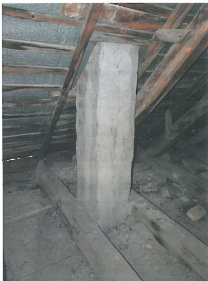
4.17. Coșul de fum de la nivelul șarpantei realizat din zidărie de cărămidă în zona racordului dintre navă și cor, latura nord, este tencuit cu material pe bază de ciment; căpriori lipsă din ferma secundară 4b
