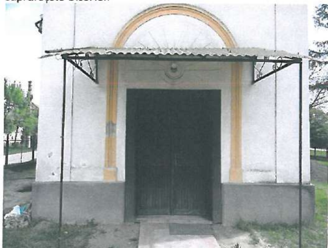
1.3. Turnul bisericii, fațada vest cu intrarea în biserică; urme de umiditate la nivelul soclului
