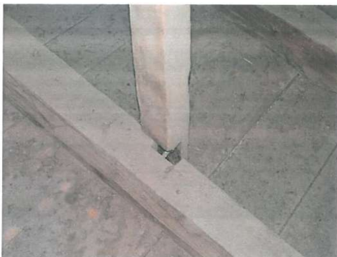
4.10. Îmbinare dislocată în coadă de rândunică între colțar transversal și coardă, mod de lucru deficitar
