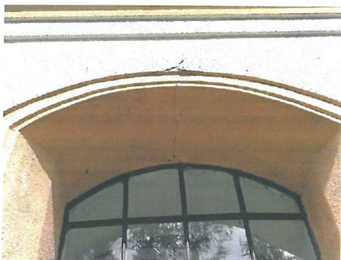
1.9. Navă biserică, fațada nord - fisură structurală tip arc de buiandrug
