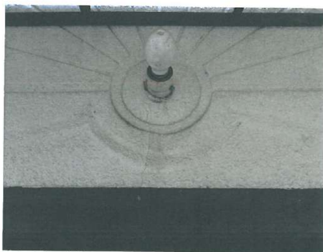
1.4. Turnul bisericii, fațada vest - fisură tip buiandrug deasupra ușii de intrare în biserică
