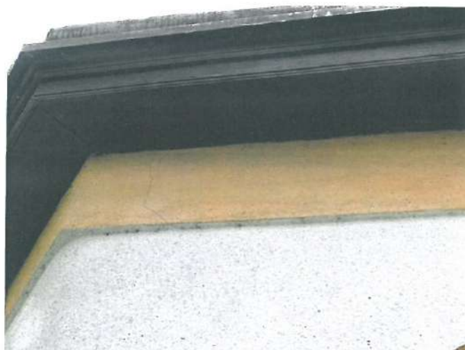
1.19. Cor biserică, fațada est - fisură la partea superioară a zidului, sub streășina bisericii
