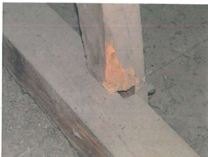
4.15. Capăt colțar biologic degradat - îmbinare colțar-coardă
