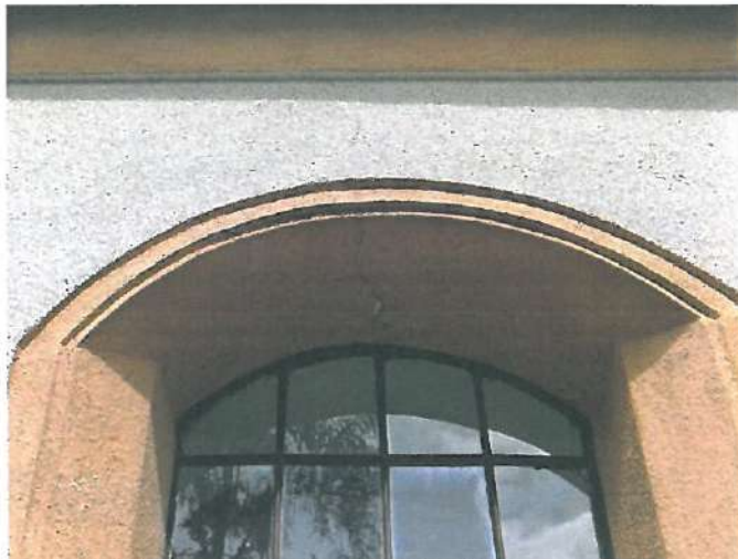
1.14. Cor biserică, fațada nord - fisură structurală tip arc de buiandrug
