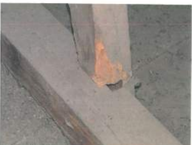
4.15. Capăt colțar biologic degradat - îmbinare colțar-coardă
