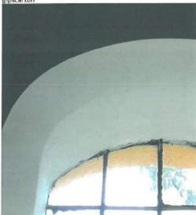
2.7. Fisuri structurale de tip arc de buiandrug prezente și pe partea interioară a zidăriei la fiecare fereastră
