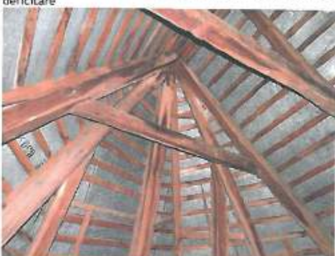
4.13. Nod câpriori degradat din cauza umidității infiltrate în zona închiderii șarpantelor
