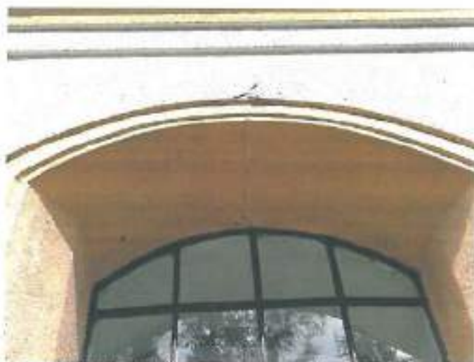
1.9. Navă biserică, fațada nord - fisură structurală tip arc de bulandrug
