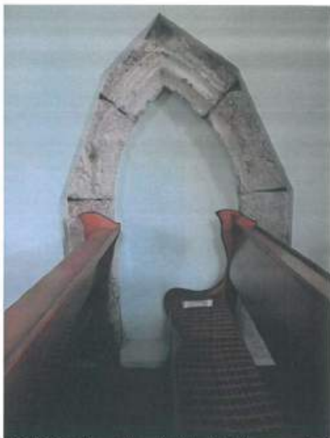
2.6. Se observă încadrământul din piatră dinspre cor al ușii sacristiei de odinioară; materialul încadrământului degradat
