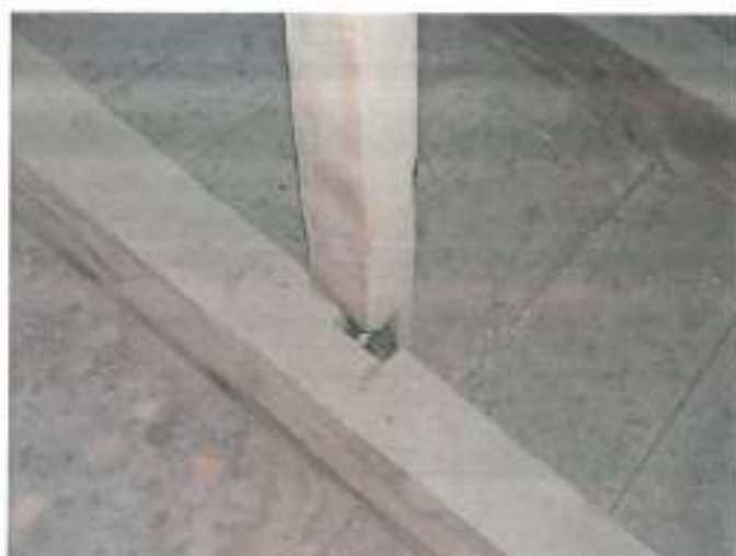
4.10. Îmbinare dislocată în coadă de rândunică între colțar transversal și coardă, mod de lucru deficitar
