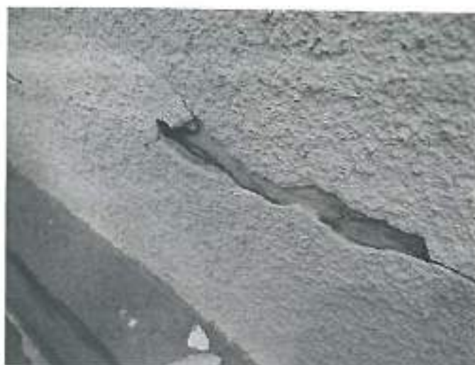
1.10. Navă biserică, fațada nord - tencuială pe bază de ciment desprinsă de perete datorită umidității din zidărie
