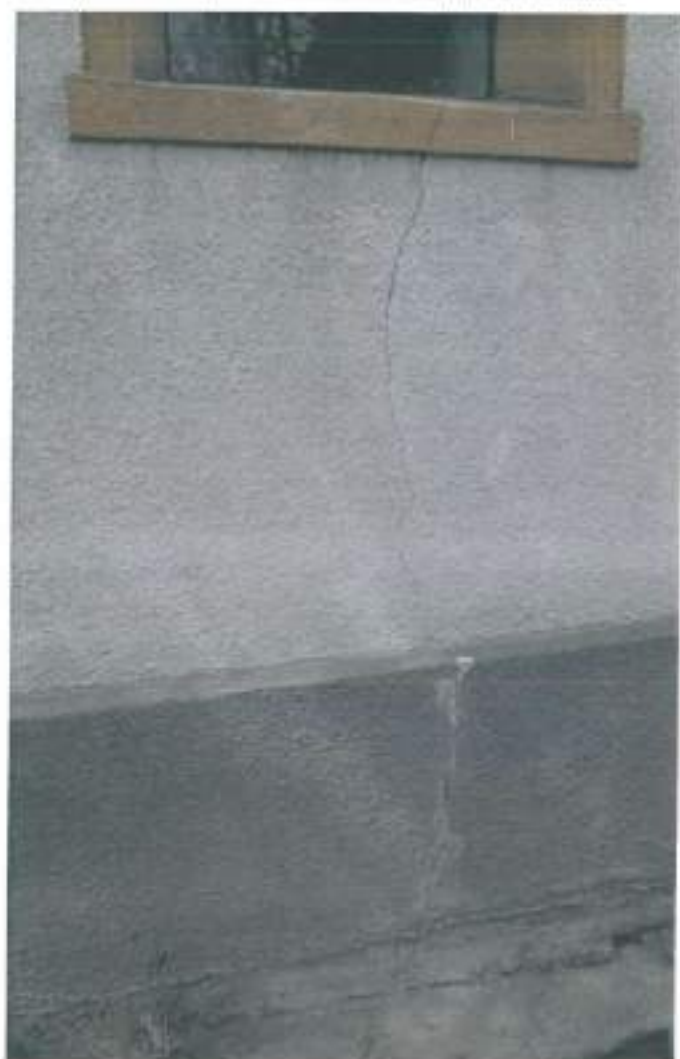
1.21. Cor biserică, fațada est - fisură structurală tip parapet, probabil continuă și la nivelul fundației (necesită cercetări suplimentare)
