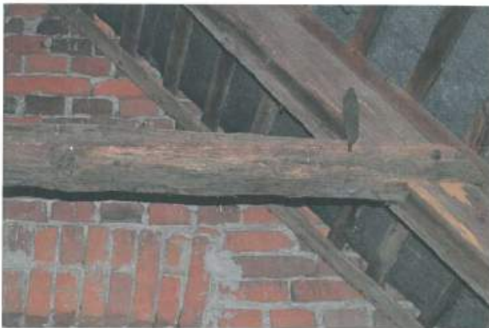
Foto 2.: Moaza din ferma 1a, degradat pe ½ din secțiune de insecte xilofage
