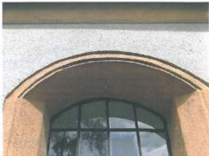
1.14. Cor biserică, fațada nord - fisură structurală tip arc de bulandrug
