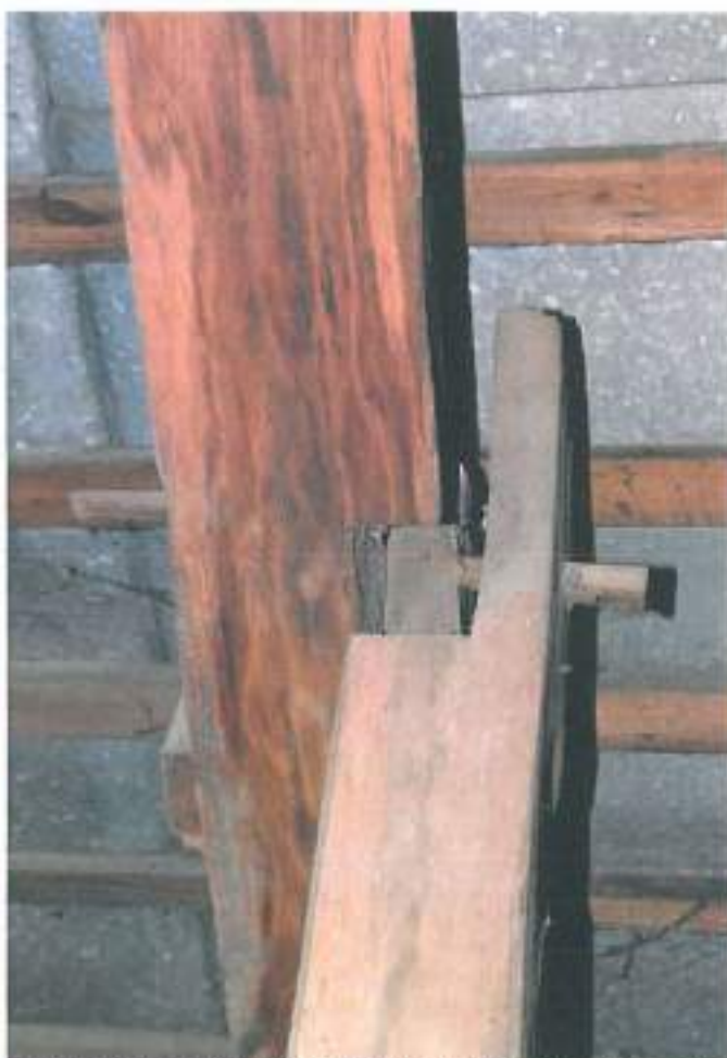
4.9. Îmbinare dislocată în coadă de rândunică între colțar transversal și căprior, mod de lucru deficitar
