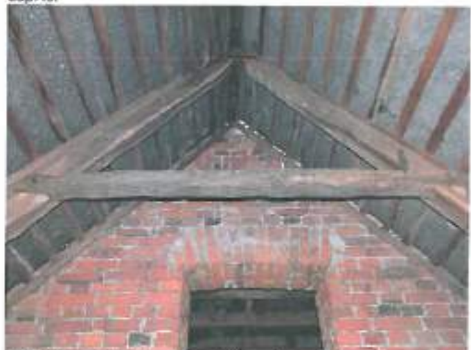
4.14. Moază biologic degradată - rezistență redusă
