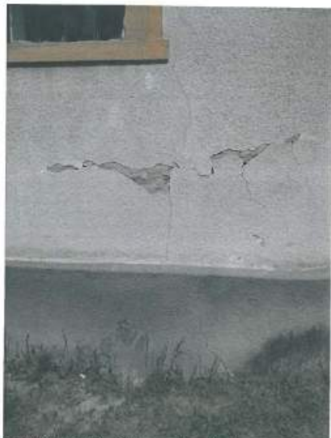
1.13. Cor biserică, fațada nord - fisură structurală tip parapet; tencuială desprinsă din cauza umidității ridicate
