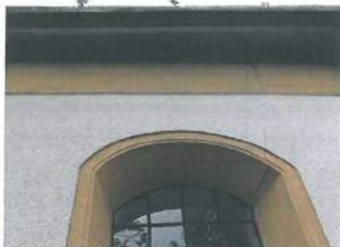
1.18. Cor biserică, fațada est - fisură structurală pornind de la colțul ferestrei și traversând zidăria până la streșină
