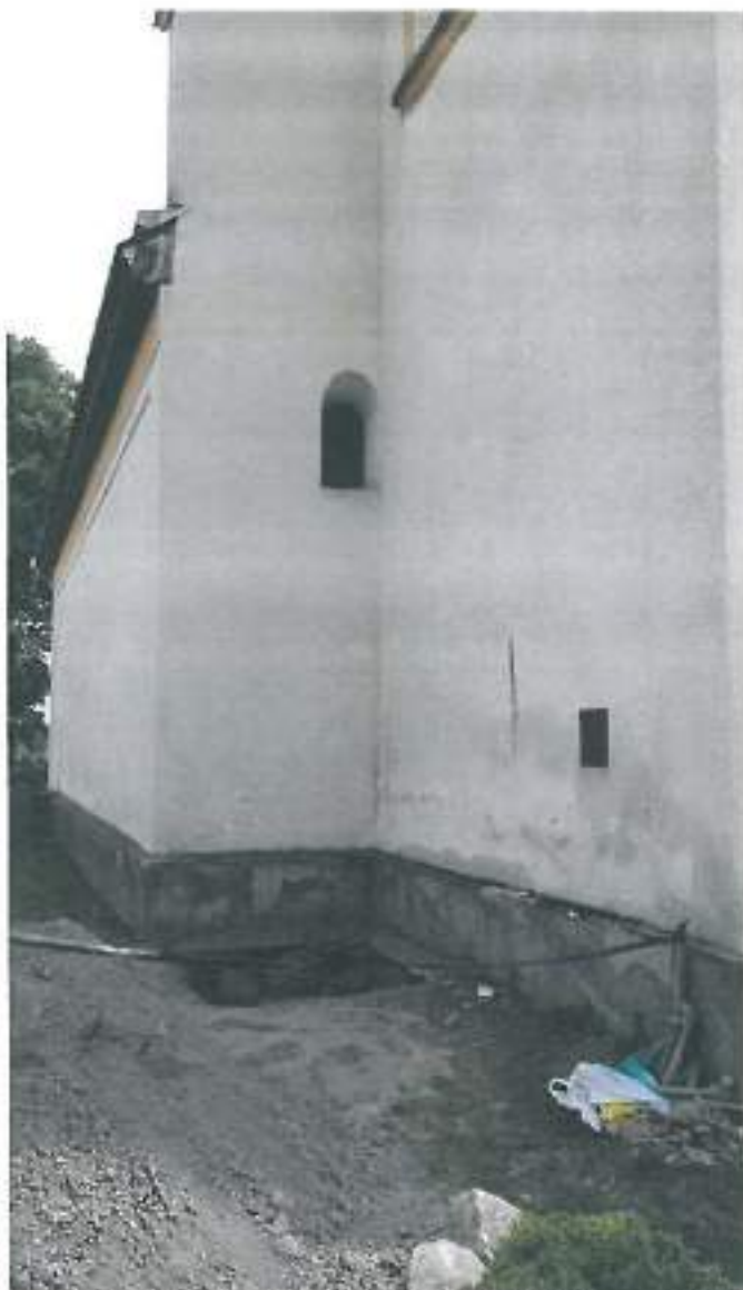
1.25. Racordul turnului cu nava bisericii, latura nordică - umiditate ridicată din cauza capilarității, finisaje degradate
