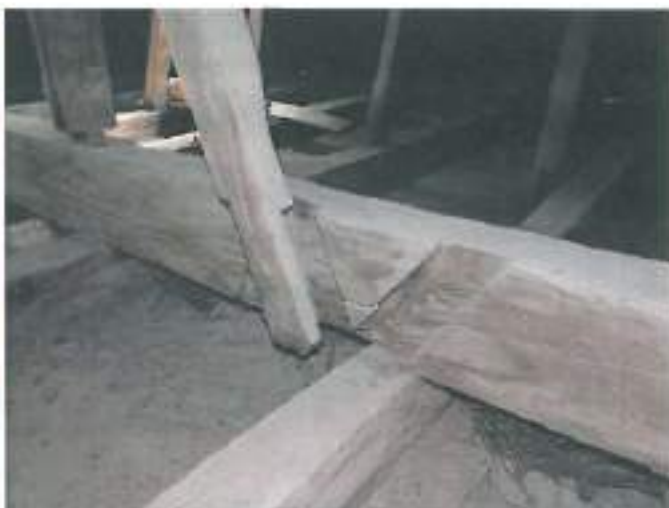
4.6. Lipsă element (colțar longitudinal) din sistemul longitudinal de rigidizare, nod colțar - grindă de suspendare dislocată
