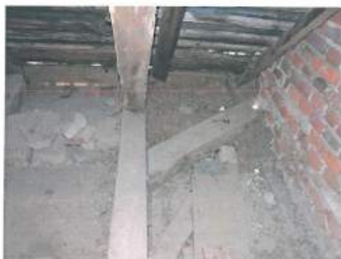
4.3. Se observă două grinzișoare așezate în diagonală în cele două colțuri ale șarpantei adiacente turnului, acestea indicând urmele unei șarpante anterioare construirii turnului, probabil țesite spre vest
