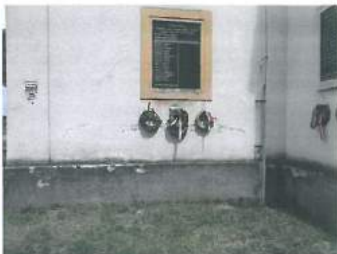
1.5. Turnul bisericii, fațada sud - umiditate ridicată pe tot conturul turnului datorită capilarității și finisajelor nerespirante
