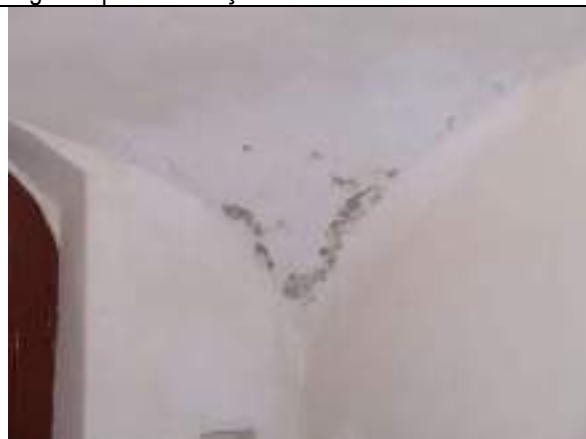
18. Infiltrații la bolta porticului.
