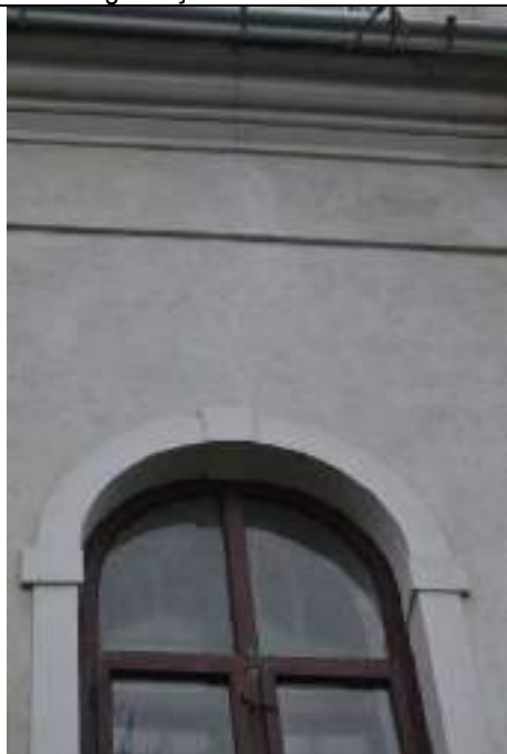
15. Fisură buiandrug la fațada nordică navă.
