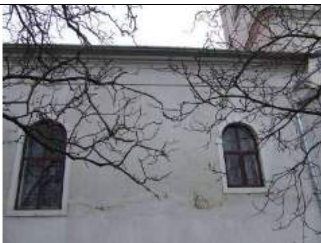
14. Igrasie puternică fațada nordică navă.
