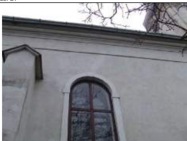
13. Fisură buiandrug la fațada nordică navă.
